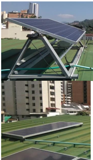
Figura 2. Izquierda: Panel con seguidor solar. Derecha: Panel solar fijo. (Fuente: Autores).
